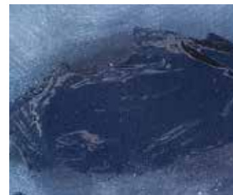
Po: Naprawa dziury z użyciem R-Flex
